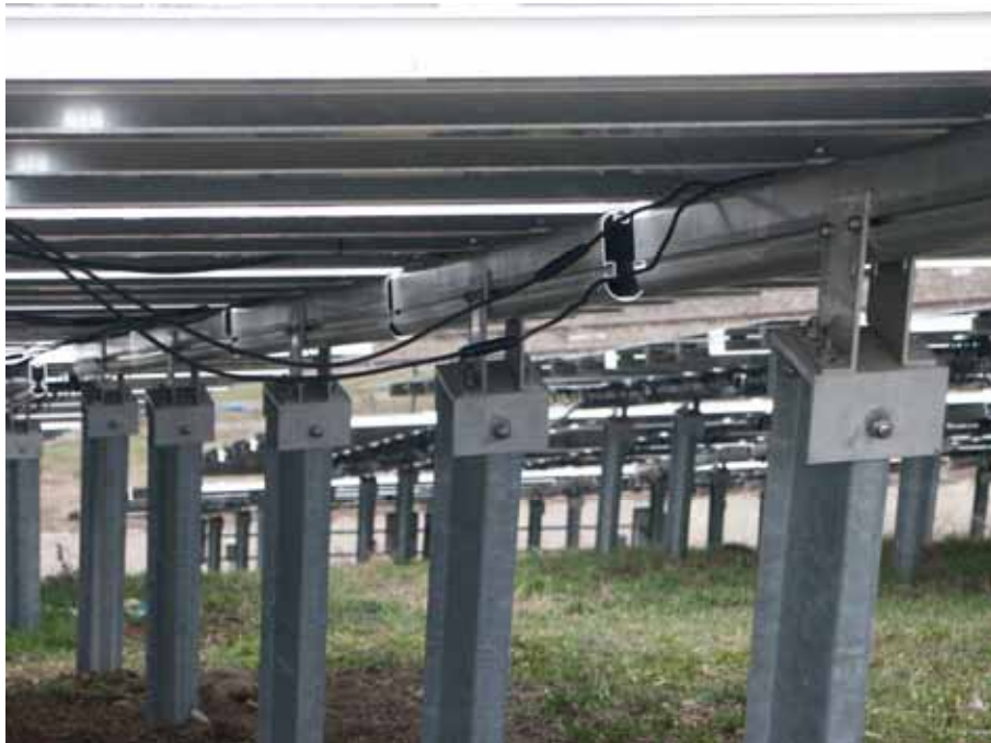
Abb. 11: Blick unter die ca. 1,20 m hohen Modultische und auf den Verstellmechanismus
