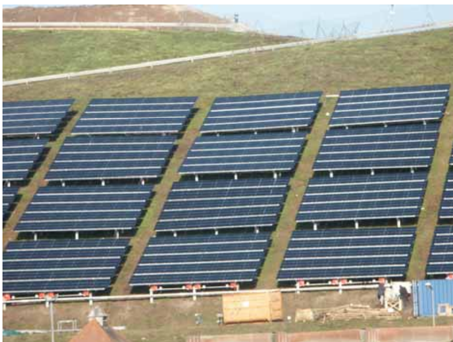
Abb. 12: Fertige Modultische am Deponiesüdhang der Abfalldeponie Karlsruhe-West
